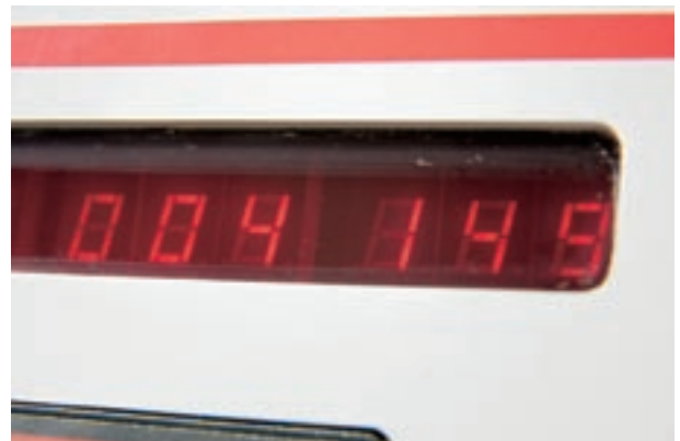
Электронный счетчик расхода воды.
